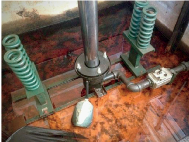
Hố Pit thang máy ngập nước
